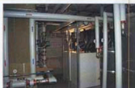
Kotłownia z systemem pomp ciepła
